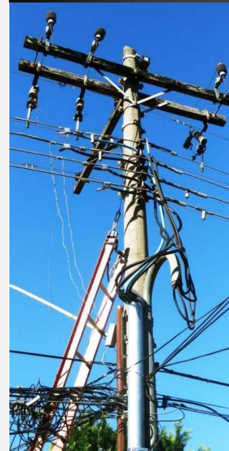
Rede Elétrica para Lavanderia Moradia
